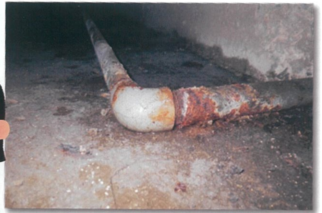
配管、腐敗して漏水してるかも…
